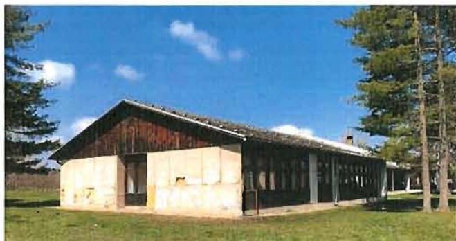
Slika 1. Karakteristično oštećenje: Oštećena obloga fasadnih zidova nove škole.
